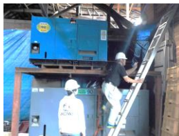
予備発電装置の稼働訓練
